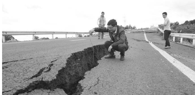
Mặt đường bị nứt toác, sụt lún nghiêm trọng
